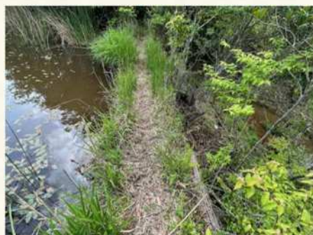
風化により決壊の危機にある堤体
